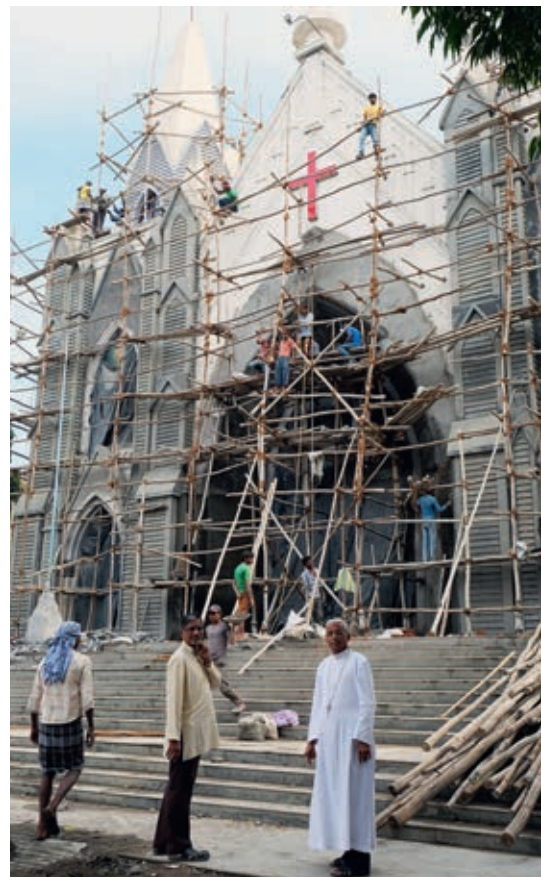
Die Bischofskirche ist der Gottesmutter geweiht. Mit Hochdruck wird daran gearbeitet, sie fertigzustellen. Bischof Miranda informiert sich über den Fortschritt. Bild: © Missio, Sylvie Roman
